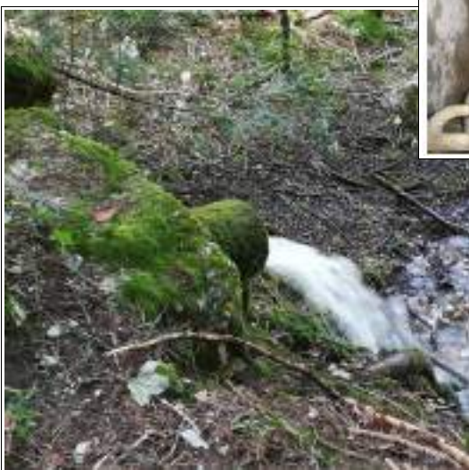
Exutoire de la vidange de la chambre de réunion (non équipé d'un système anti-intrusion)
